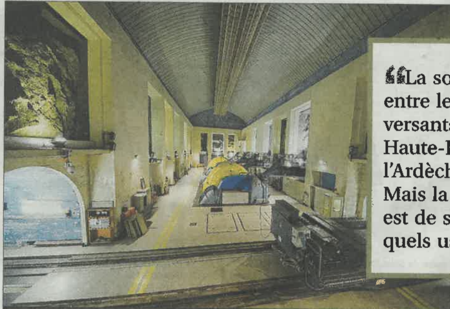
FONCTIONNEMENT. À 120 mètres sous terre, la centrale de Montpezat-sous-Bauzon en Ardèche turbine les eaux du bassin-versant de la jeune Loire et des hauts plateaux (environ 200 millions de m 3 par an) qui sont détournés de leur bassin-versant naturel. PHOTO D'ARCHIVES LIONEL CIOCHETTO
