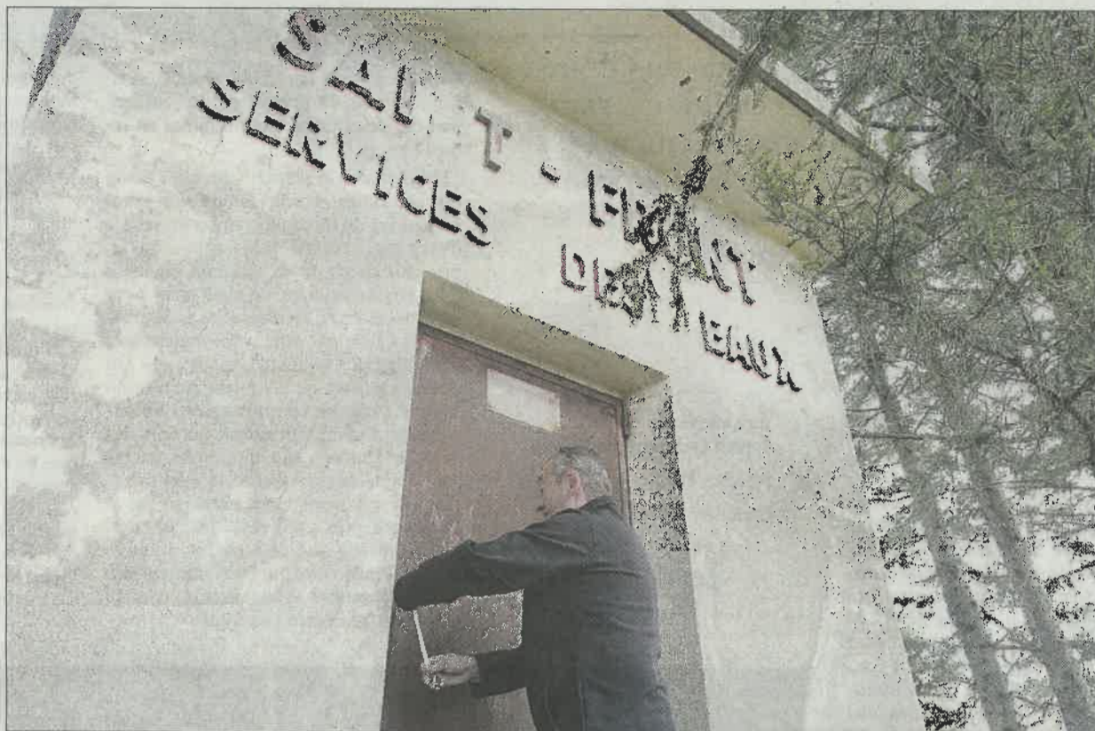
RÉSERVOIRS. Le maire et ses agents sont attentifs au bon état des réservoirs où dans quelques jours des compteurs seront posés.
